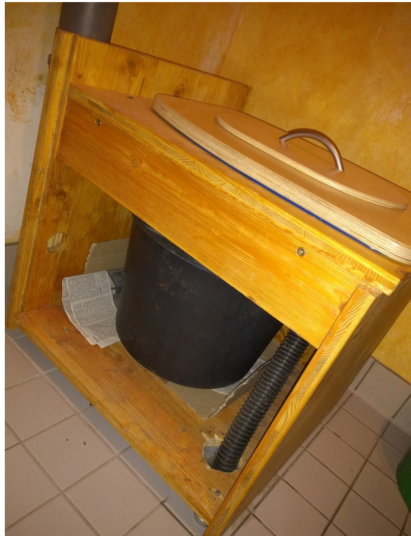
Abbildung 22: Kompost-Trenntoilette in der Wönnichstr. 103. Separate Urinabführung vorne, trockene Sammlung der Fäzes im Eimer hinten. Abluftabführung über Rohr zum Dach. Quelle: eigenes Foto
