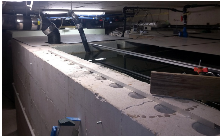
Abbildung 21: gemauerter Tank zum Speichern des Niederschlagswassers im Keller von LaVidaVerde, Quelle: eigenes Foto
